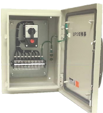
盤内取り付け
